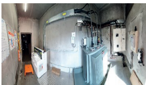
Nouveau poste HT/BT
