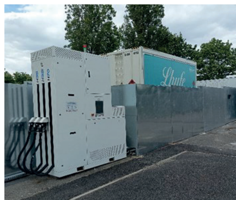
Bornes de distribution en H2
